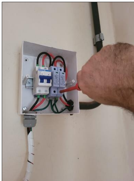
Fotografia 3 – Inspeção em disjuntores, DPS (dispositivo de proteção de surtos) e controlador de carga de sistema fotovoltaico
