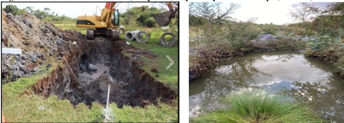
Figura 2 - Início das obras no local (à esquerda) e após um período de tempo (à direita)
